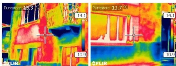
Parete sud vista con termocamera (sono evidenti le modifiche alle aperture e l'inserimento di architravi)
